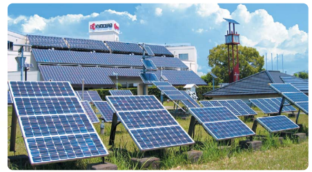
1984年稼働開始の佐倉ソーラーエネルギーセンターは、いまでも現役で稼働しています。
